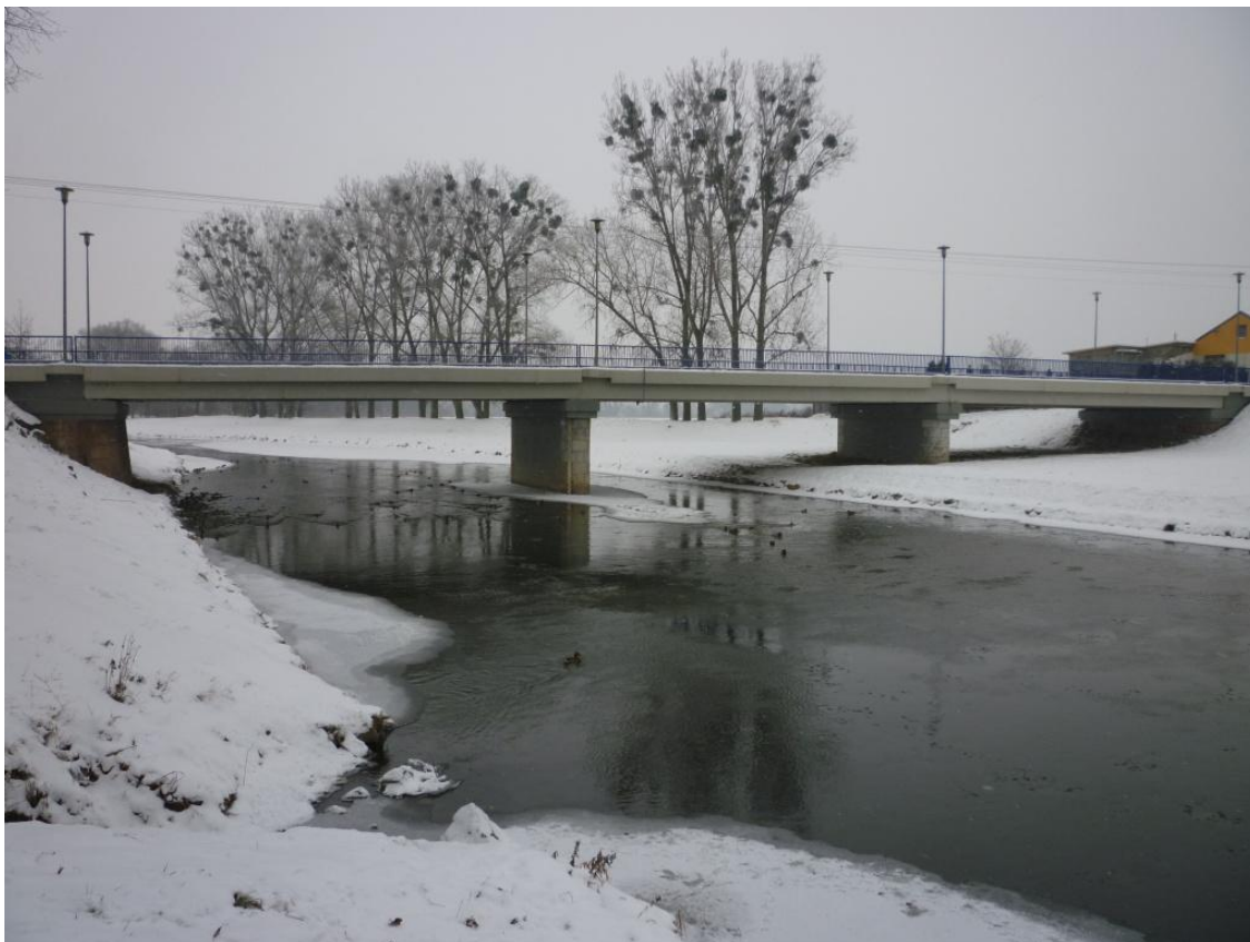
Obrázek 14 – Pohled na silniční most po proudu, Kravaře – Dvořísko, ul. Tyršova, km 27,128 (TPE 26,680)
