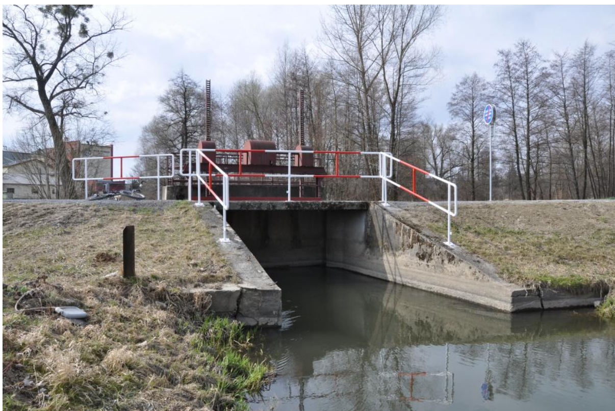
Obrázek 42 – Nátokový objekt do Mlýnského náhonu v ochranné protipovodňové hrázi v pravém inundačním území, km 41,020
