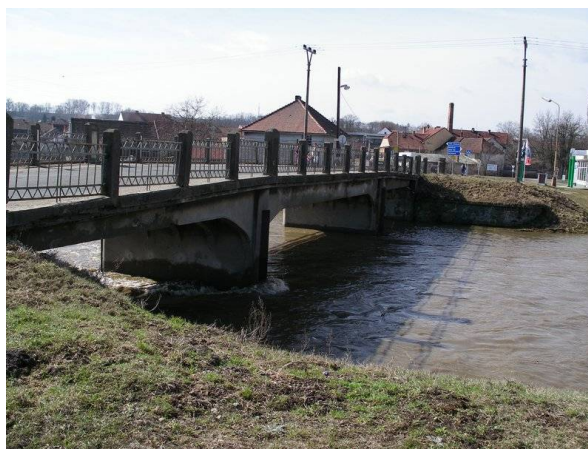
Obr. č. 3 Povodeň 2006 – silniční most ul Krumlovská
