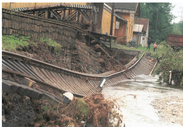
Obr. č. 3 Povodeň 1997 – nádraží Loučná n. Desnou
