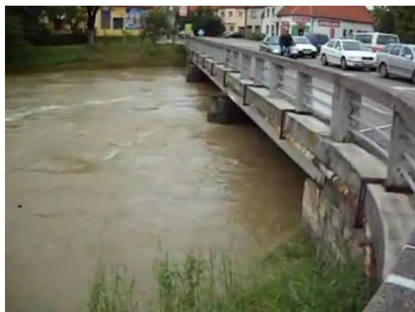
Obr. č. 6 Povodeň 2010 – sil. most ul. 26. dubna
