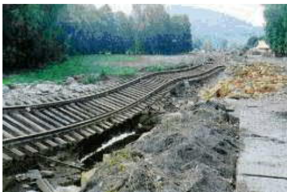
Obr. č. 6 Povodeň 1997 – žel. trať Ruda n. Moravou
